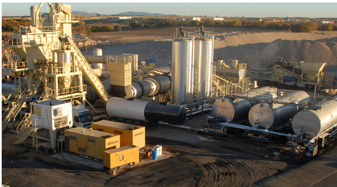
Figura 20: Central de fabricación con doble tambor (Fuente: Sacyr)
