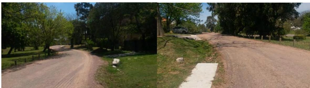
Figura 15 - Estado general de la calle Fausto a los 8 meses de ejecutada
