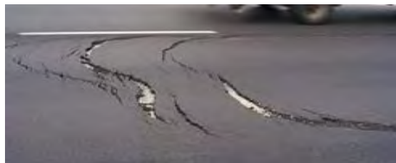
Figura 4. Fisura o grieta parabólica.
