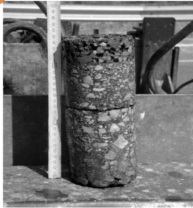
Figura 5. Testigo donde la capa intermedia está separada de la capa de base.
